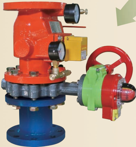
▲ LUG형 템퍼 버터플라이밸브와 알람밸브를 배관한 상태
