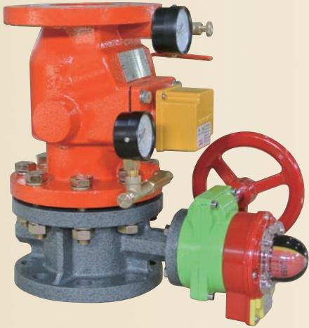
▲ FLANGE형 템퍼 버터플라이밸브와 알람밸브를 배관한 상태
