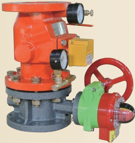
▲ FLANGE형 템퍼 버터플라이밸브와 알람밸브를 배관한 상태
