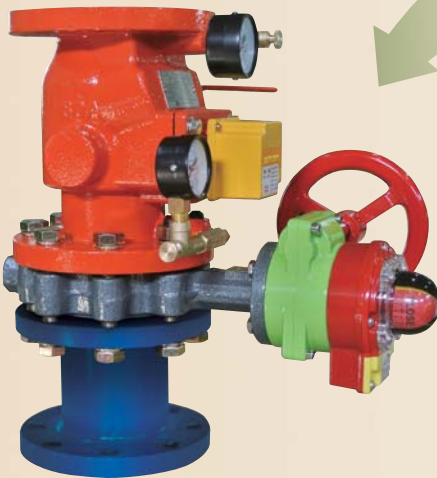
▲LUG형 템퍼 버터플라이밸브와 알람밸브를 배관한 상태
